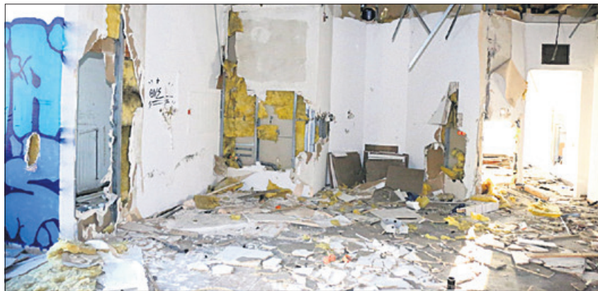
Auf dem Gelände des ehemaligen Einkaufszentrums kam es häufig zu Vandalismus. Foto: tan
