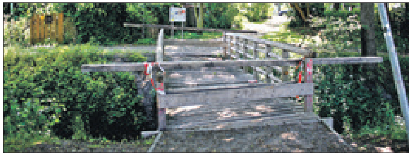
Ohne die Anwohner zu informieren, wurde die Holzbrücke gesperrt.
