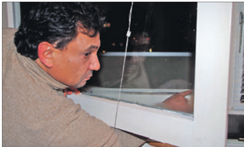
Lotfi Ben Hassine zeigt an den noch vorhandenen Holzfenstern, wo es beim nun getauschten Schlafzimmerfenstern durchnässte. Foto: mvo
