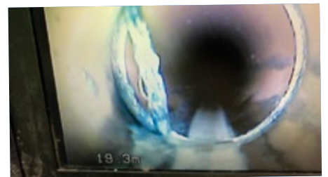
Hier stimmt was nicht. Auf der linken Seite seht ihr, das hier eine undichte Stelle ist. Diese muss nun von einer anderen Firma repariert werden.
