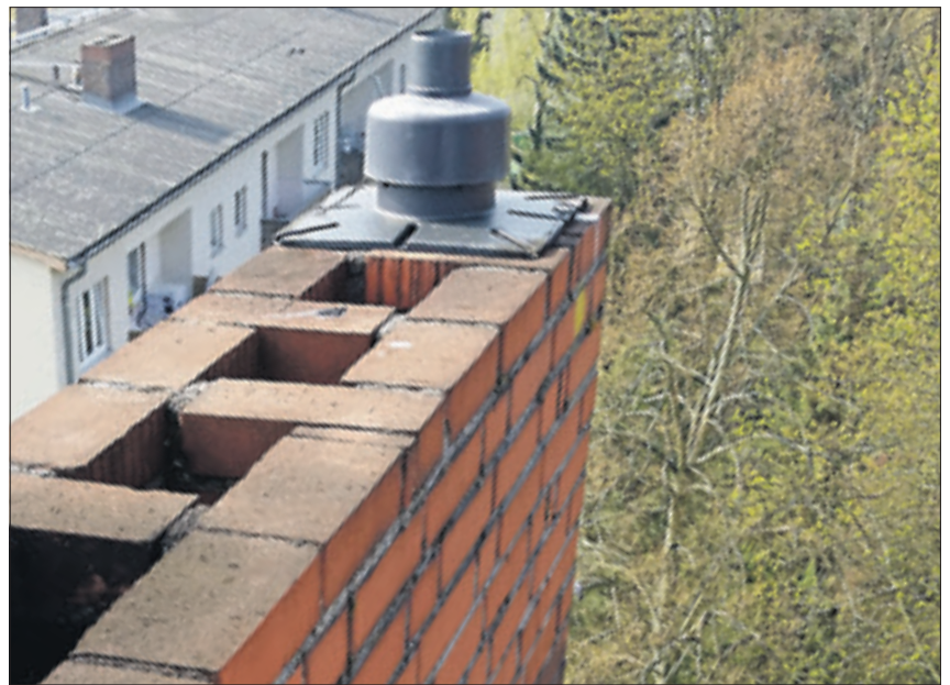
Bei diesem Schornstein ist nur ein Zug in Benutzung und regensicher verschlossen. Foto: mvo
