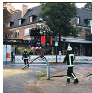
Einsatz nach der Unterspülung
