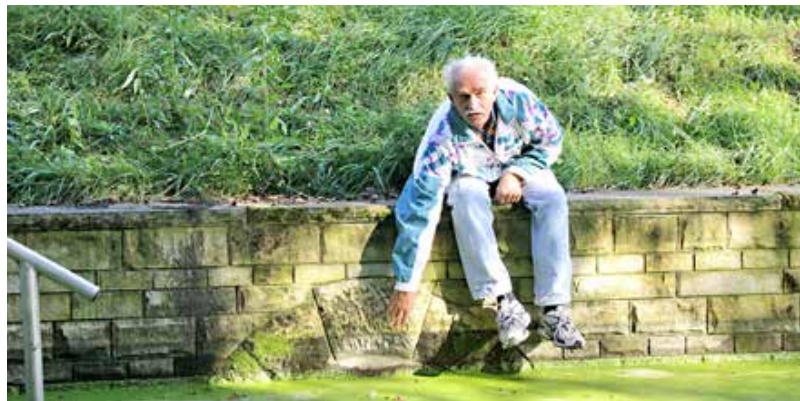
Rolf Degen zeigt es an: Der Durchlass des Weidengrabens unter der Hennigsdorfer Straße liegt unter der Wasseroberfläche.
