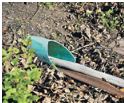
Das kleine Rohr und ein Schlauch reichen bei Starkregen zum Ableiten nicht aus. Foto: fle
