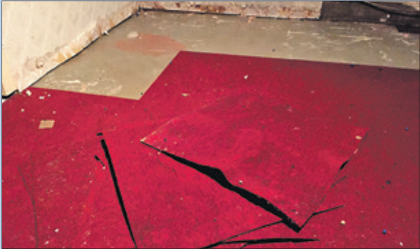
Wasserschäden im Keller nach Starkregen
