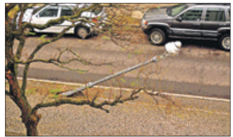
Die beschädigte Laterne
