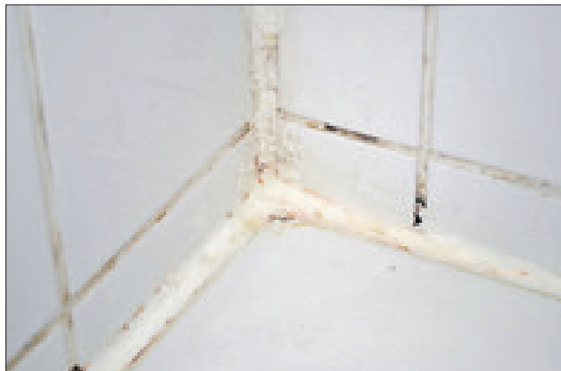
Solche Fugen sind unsachgemäß – Zeit für den Austausch! Foto: mvo
