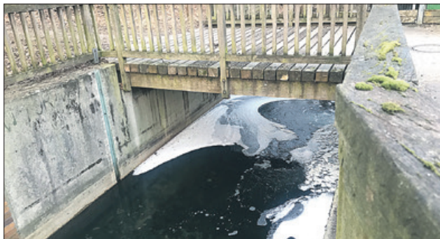
Das Wehr lenkt das Wasser über einen Umweg in die Oberflächenwasser-Aufbereitungsanlage. Foto: fle
