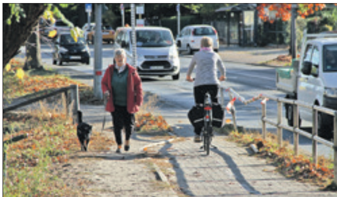
Für Radfahrer und Fußgänger ein Graus: der Weg neben der Oranienburger Straße auf Höhe der Einmündung Hermsdorfer Straße. Foto: bek
